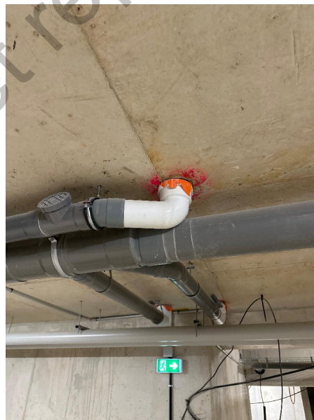
Reprise d'EP non conforme
