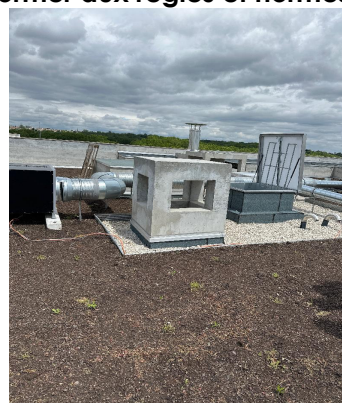
Liaisons électriques sans protection
