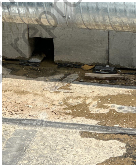
Découpe pour batardeau Calage non conforme
