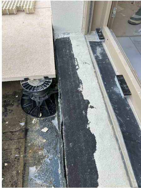
Protection en tête non conforme
