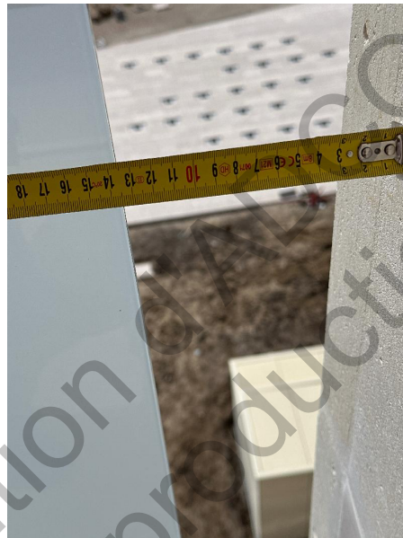
Écartement non conforme
