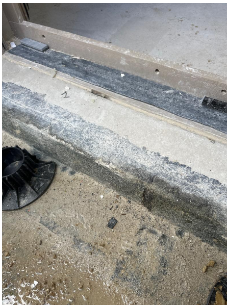
Encastrement du seuil bois de la porte fenêtre – absence de rejangots
