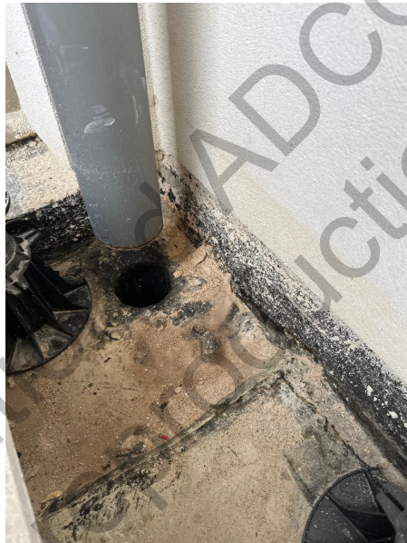
Protection en tête non conforme
