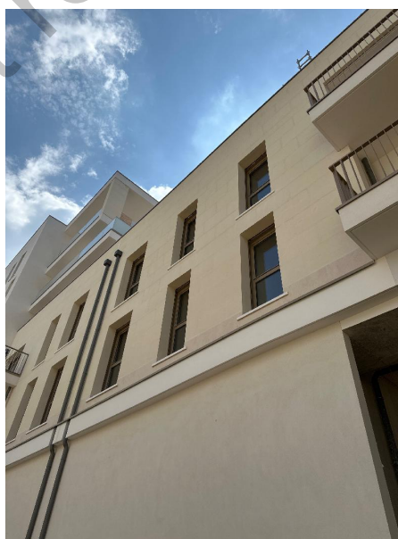
Absence de goutte d'eau
