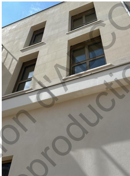
Absence de goutte d'eau
