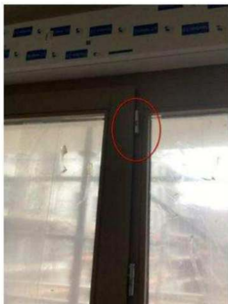
Paumelles endommagées à certains emplacements.
