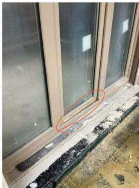
Absence des rejets d'eau au niveau des fenêtres.
