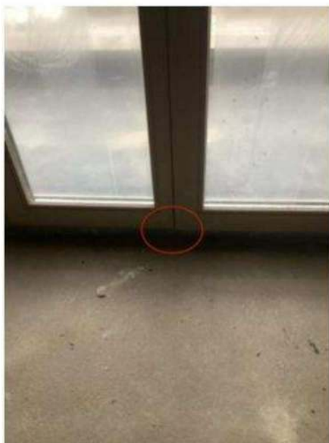
Manque le réglage des portes-fenêtres.
